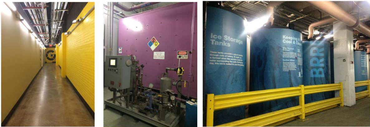
Figure 25. Intérieur du 111 8th avenue. Avec cuve de fioul et stockage thermique. Crédit =©Cécile Diguët et Fanny Lopez, 2018.
